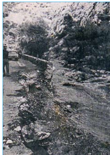
La route des Gorges a été emportée au niveau de l'embouchure du Destel.
