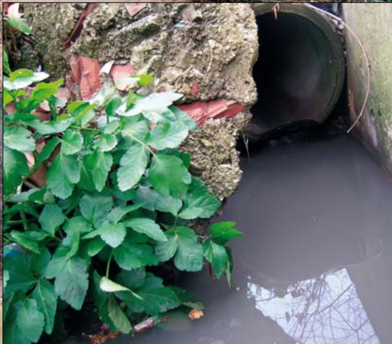
Rejet d'assainissement dans le milieu au niveau de Dardennes.
