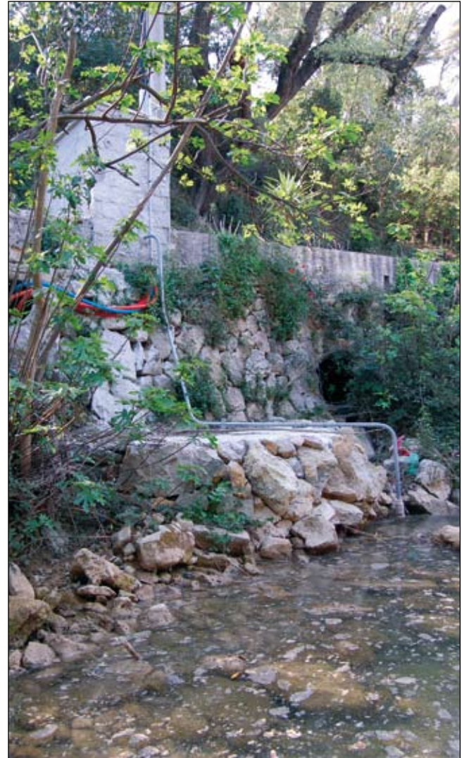
Pompage municipal de Dardennes qui sert à l'alimentation esthétique d'une ancienne portion du Béal.
