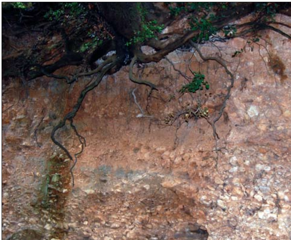
Les berges du Las, au niveau du Pont de Dardennes, sont constituées de terrains alluviaux. Les crues ont sapé la rive jusqu'à mettre à jour les racines d'un gros arbre qui attend la prochaine crue pour tomber.
